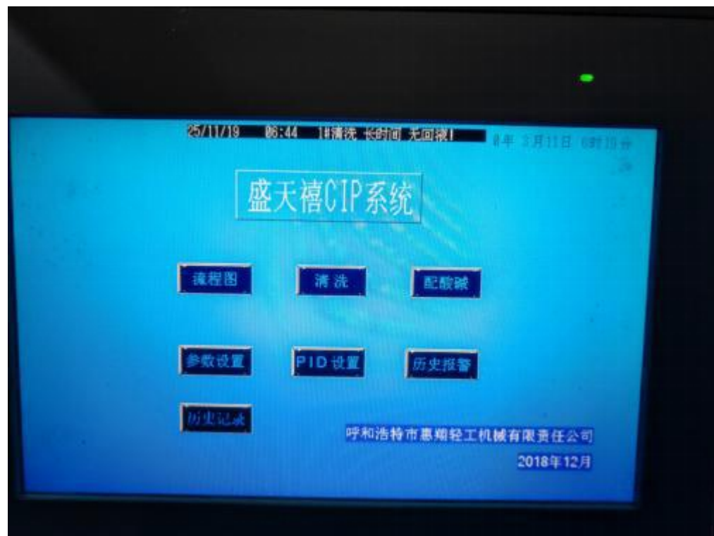
CIP清洗系统
